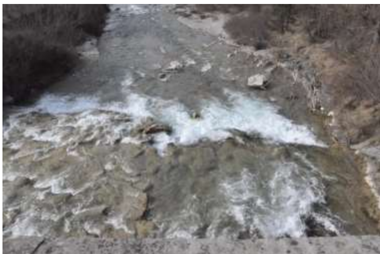
Et des zones d'érosion, jusqu'au substrat, en aval du pont de Recoubeau...
