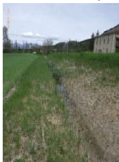
Figure 70 : Fossé drainant le long de la D93
