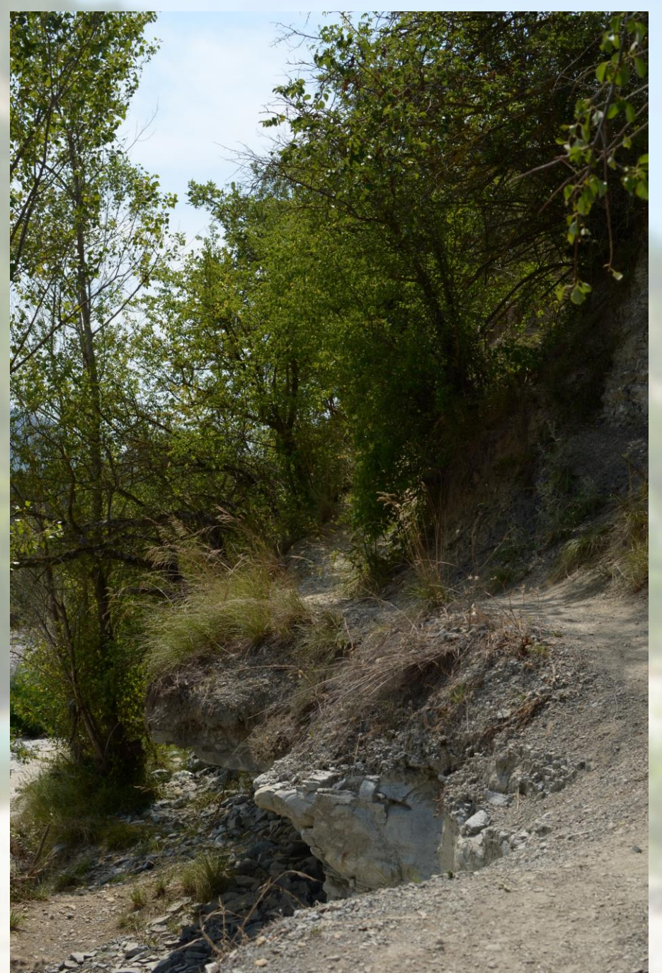
Dégradation physique des milieux
